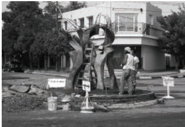
En el marco del festejo de la localidad de Guatraché, se está construyendo el Monumento del Centenario, obra ganadora de Mauro Stefanazzi.
