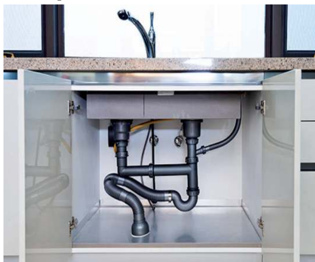
Sifones y cañerías de los bajo mesadas, suelen taponarse con frecuencia, pero su limpieza es muy fácil.
